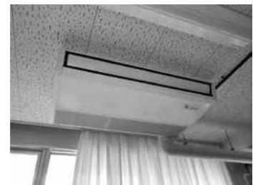
▲小学校空調機器
